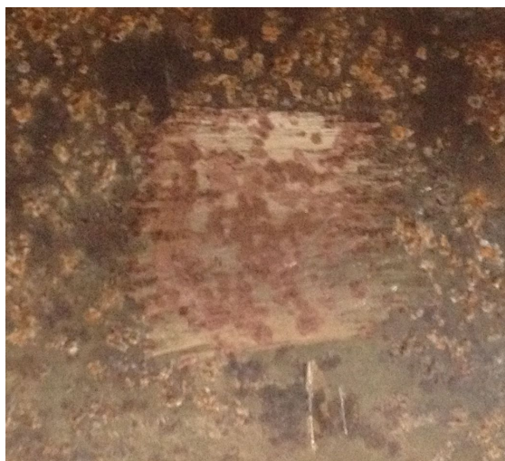
Bild 2. Korroderad avzinkad mässing
